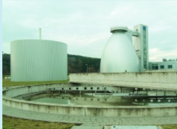
Klärwerk Gera – Ein Plus für die Umwelt: Rund 70 Prozent des Energiebedarfs des Klärwerks Gera stammt aus der eigenen Klärschlamm-Verstromungsanlage.
