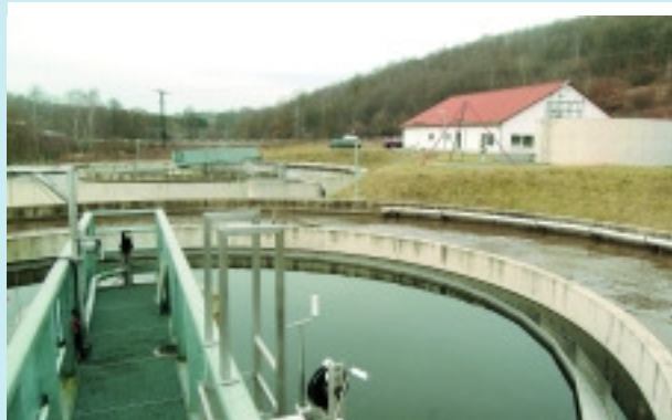
Das Klärwerk Ronneburg erfüllt die strengen Normen der Europäischen Union: Hier werden die Abwässer von rund 10.000 Einwohnern gereinigt.
